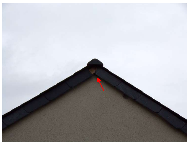
Figure 11 : Localisation de l'accès au nid sur la façade du 33 rue de la Paternelle
