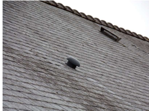
Figure 9 : Chapeau de ventilation de toiture sur le site
