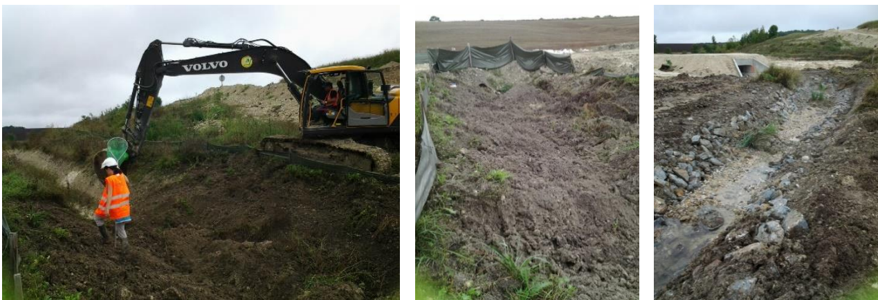
FIGURE 8 : PHOTOS D'UN EXEMPLE DE GRIFFAGE DE COURS D'EAU AVANT DESTRUCTION ET DE LA REUTILISATION DE LA VEGETATION SUR LE NOUVEAU TRACE – T HERCE
