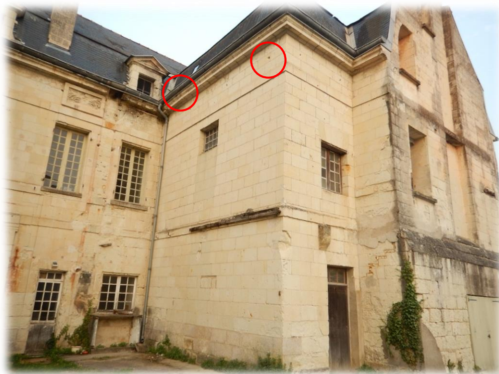
Figure 10 : Illustration des sorties de gîtes observées à l'angle nord-ouest du bâtiment
