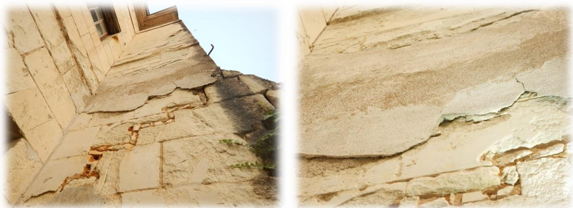
Figure 7 : Illustration de « plaques d'enduits » partiellement décollées du mur
