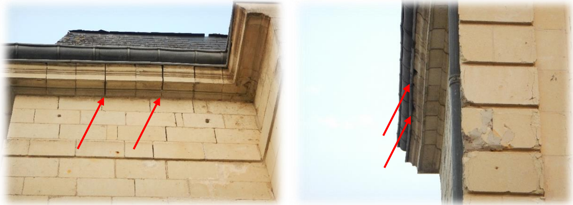
Figure 8 : Illustration des disjointements et anfractuosités présents au niveau de la corniche.
