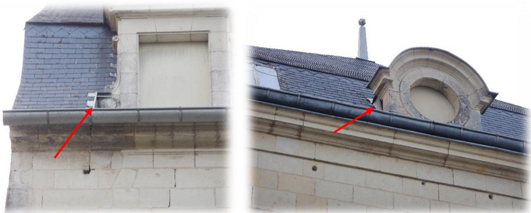
Figure 9 : Illustration des accès au comble depuis l'extérieur présents au niveau de certaines lucarnes.
